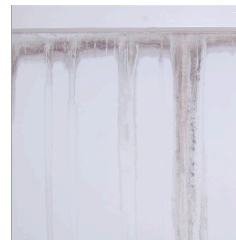
(d) Visible mold growth on plywood "windows"
