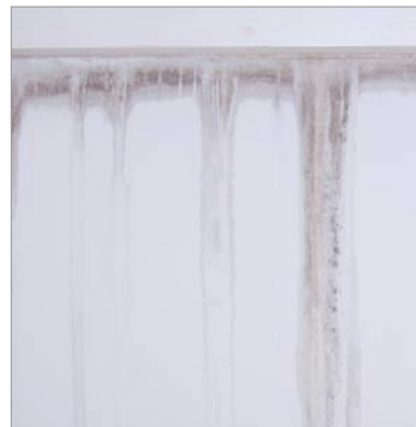
(d) Visible mold growth on plywood "windows"
